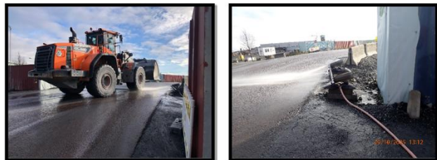
Bilder 1 og 2: Som viser spyle vannsystem. Bilder fra Statsforvalteren i Østfold, Buskerud, Oslo og Akershus.
